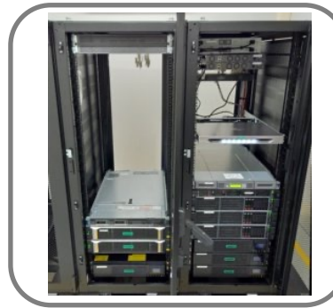
サーバールーム
