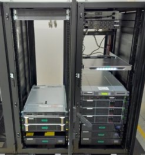
サーバールーム
