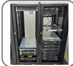
サーバールーム
